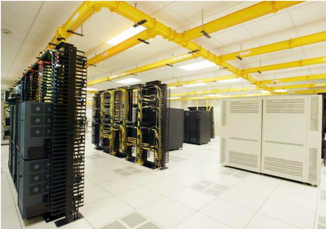
Slika 1: Izgled tipičnog data centra
